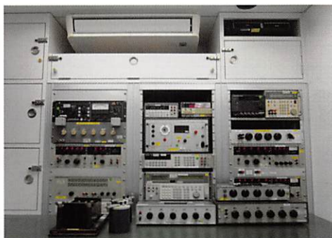
巡回試験車内
