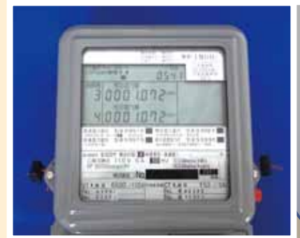
主に工場やビルで使われている電気メーター
