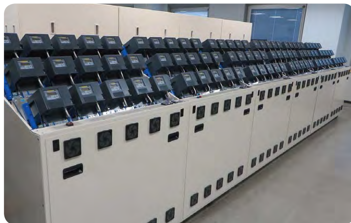
▲スマートメーター用検定設備の一例
