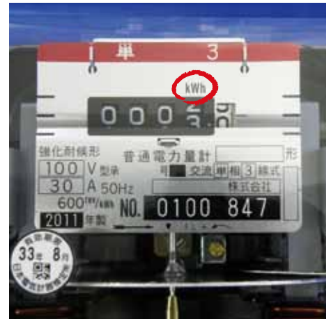
電気メーター
